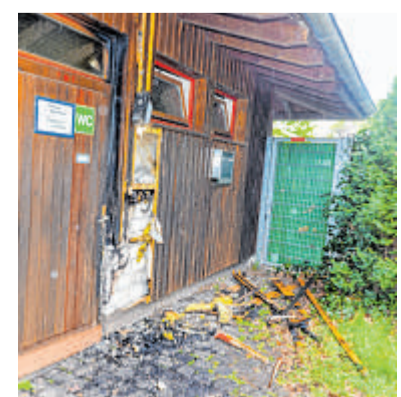
So sah das Toilettenhaus nach dem Brand Ende April aus. FOTO: THOMAS NITSCHKE
